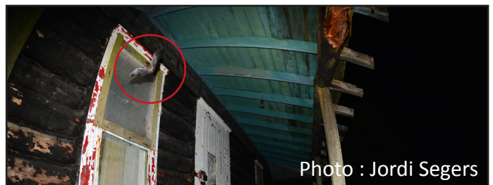
Figure 12. Pour que l'exclusion réussisse, il est important de sceller tous les autres jours et espaces par lesquels les chauves-souris pourraient accéder au bâtiment.
